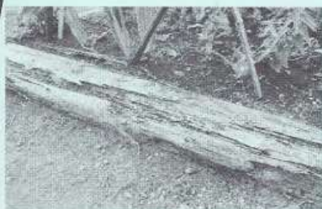
腐食した花壇枠の例
